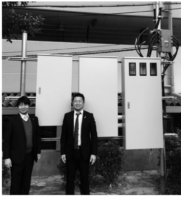
枚方市に対して寄附をした 岡東中央公園の受電・配電設備 (右：坂 禎 俊 哉 枚方オクトーバー フェスト実施組織統括リーダー) (左：岩 本 健 枚方オクトーバー フェスト実施組織事務局長)
